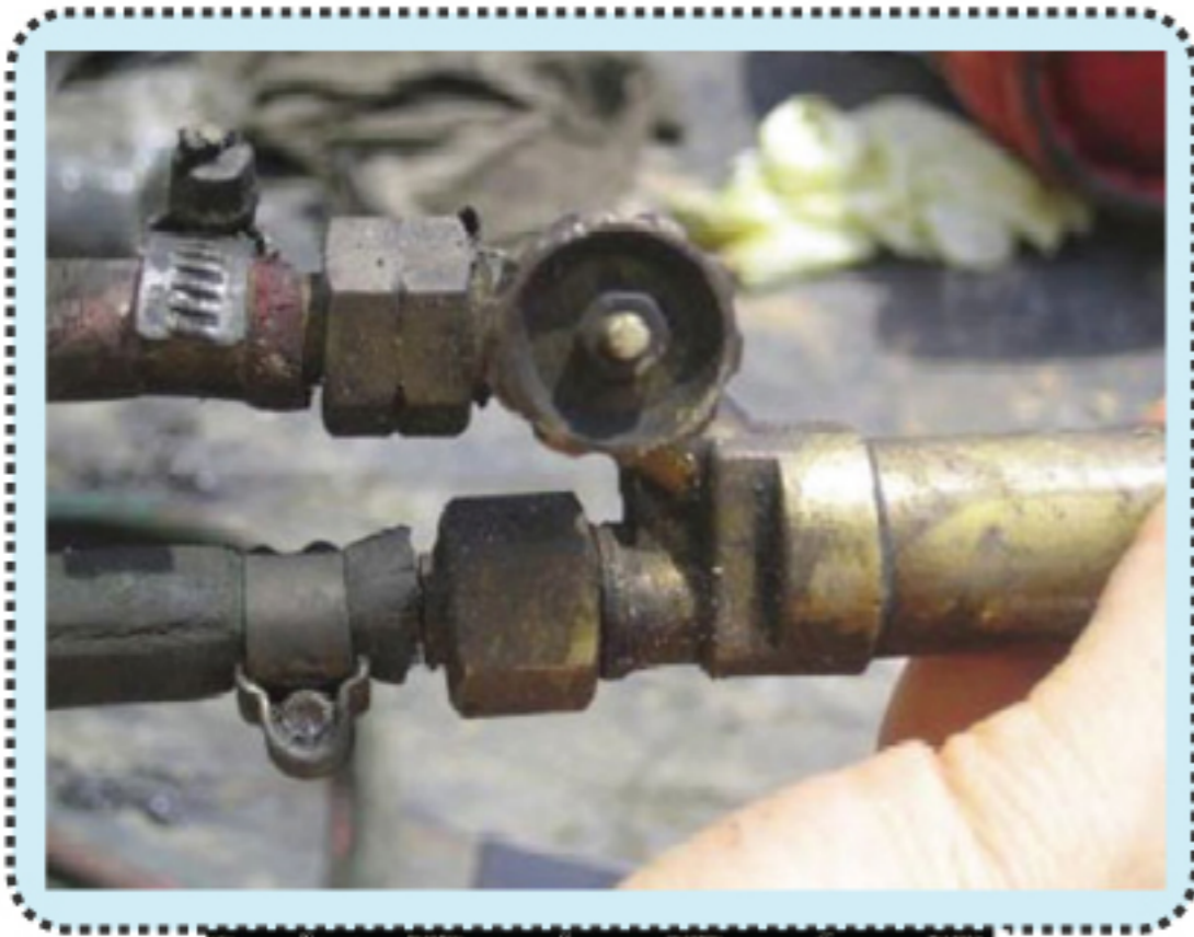
หัวเชื่อมแก๊ส (Torch) มีได้มีการติดตั้ง Flashback Arrestors แต่อย่างใด
