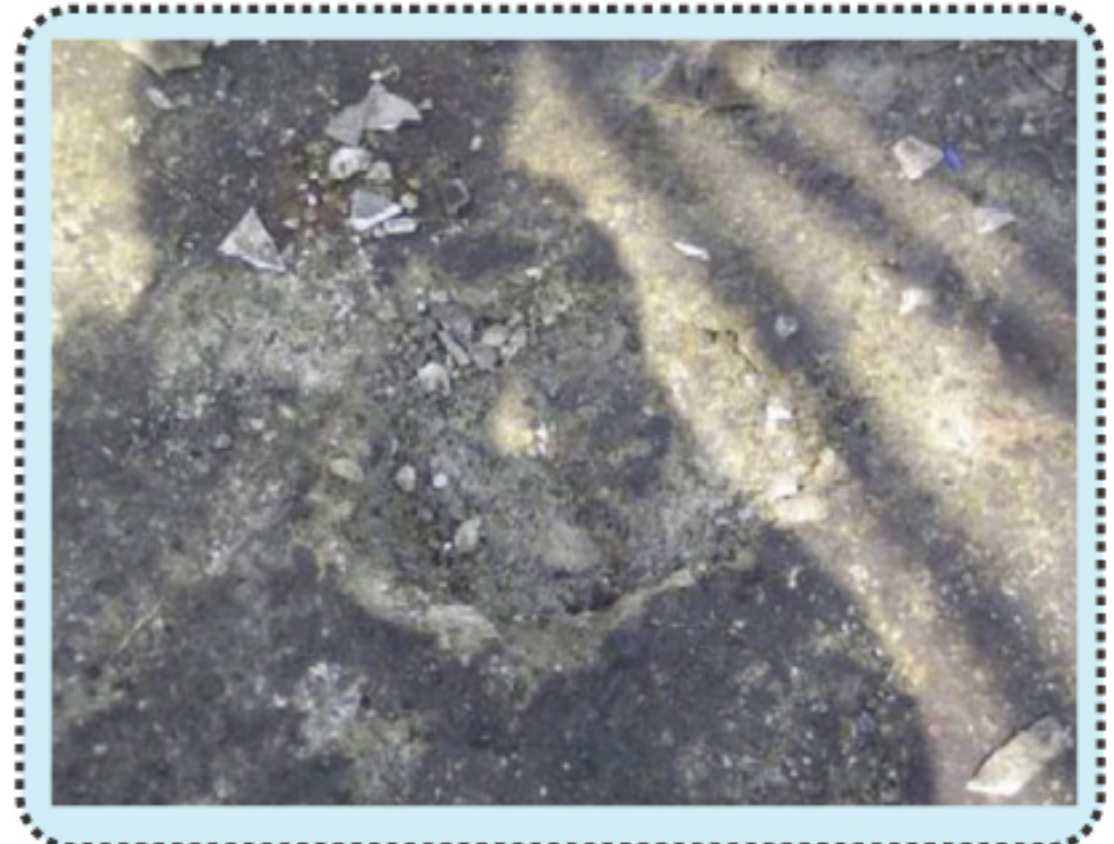
สภาพของหลุมระเบิดบนพื้นคอนกรีตเสริมเหล็ก แตกและกรุดตัวจากการระเบิดเป็นรูปถังออกซิเจน แสดงถึงการระเบิดขณะถังออกซิเจนวางอยู่ในแนวตั้ง
