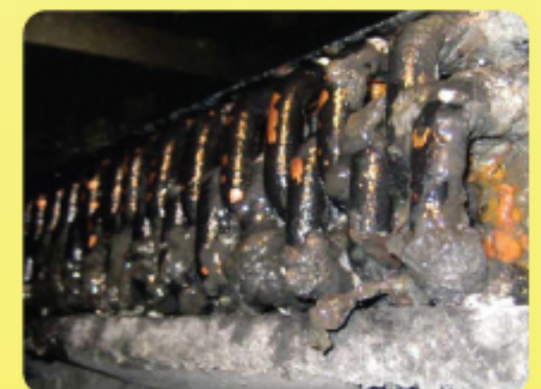
คอยล์เย็นในระบบปรับอากาศ ที่มีไบโอฟิล์มจับหนาแน่น
