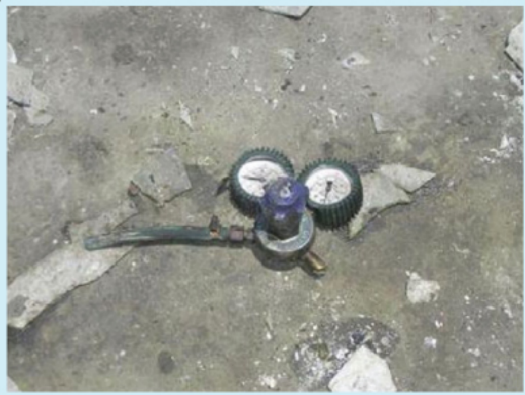
Regulator ของถังออกซิเจนมิได้มีการติดตั้ง Flashback Arrestor แต่ประการใด
