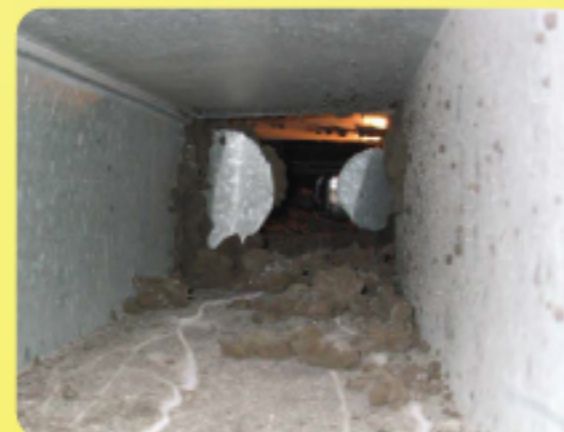
สภาพภายในท่อส่งลมเย็น ที่เต็มไปด้วยฝุ่นและเชื้อรา
