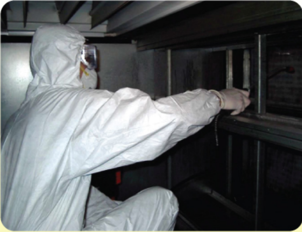
คอยล์เย็นในระบบปรับอากาศ ที่มีไบโอฟิล์มจับหนาแน่น
